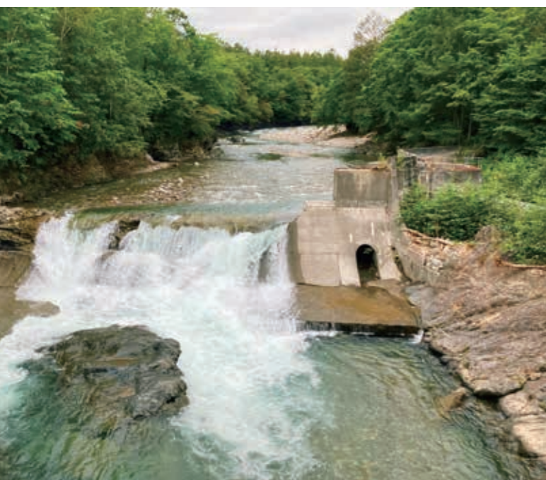
写真2 橋から見えた取水堰。洪水の影響か、かなり土砂の堆積と破損が見られ、使われていない様子。
